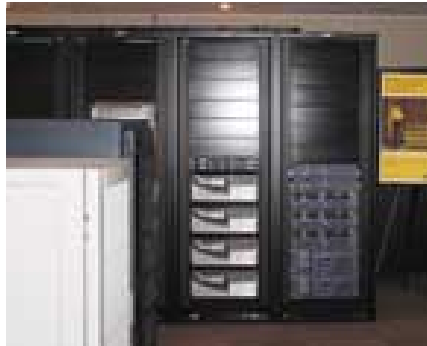
各メーカーのサーバやストレージ製品が集められている。 写真2 JECのサーバ、ストレージ群
