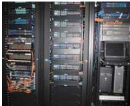
すべてのネットワークケーブルがここに集約されている。 写真3 JECのネットワークゲートウェイ
