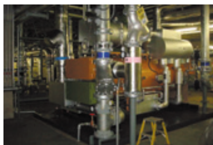
写真3 ターボ冷凍機
