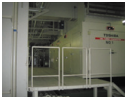
写真4 CGS(コ・ジェネレーションシステム)
