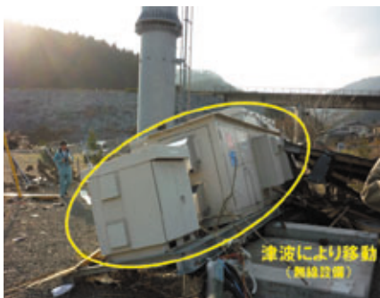
写真1 津波により移動した基地局
