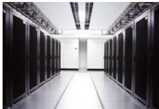
データセンターのサーバールーム
