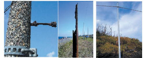
火山ガス・酸性雨により、溶解・腐食した電柱 粉体塗装を施した電柱
